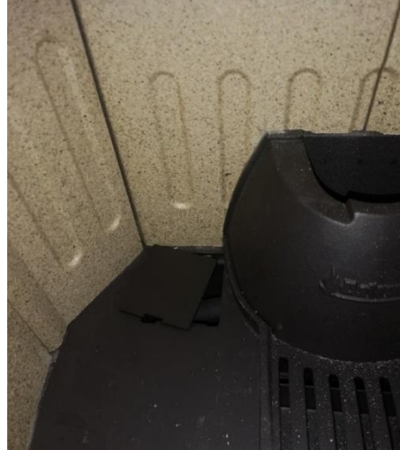
Foto 2: trampilla mal colocada
